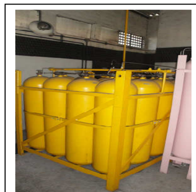
fig 5. 5. Verificar o estado dos cilindros de estocagem, assim como toda a tubulação do sistema, com relação aos sinais de ferrugem.
