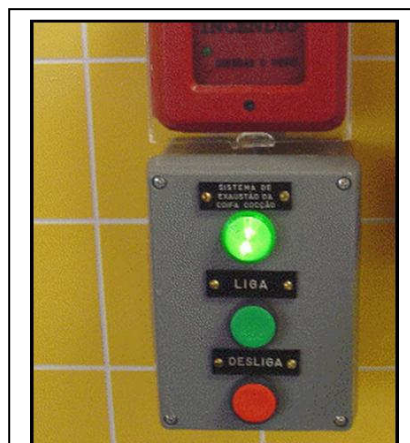
fig 4. Paralisar imediatamente todas as operações da pista de abastecimento do posto e pressionar o botão para desligar a energia elétrica dos equipamentos de pista.
