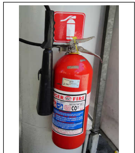
fig 12. Extintor de incêndio de CO2.
