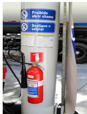
fig 2. 6. Periodicamente deve-se verificar se os extintores estão posicionados nos lugares corretos e se estão dentro do prazo de validade;
